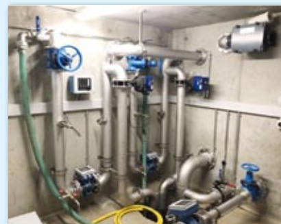
Arrivées des sources, vannes de décharges et turbidimètre. Photo: Quentin Morezzi
