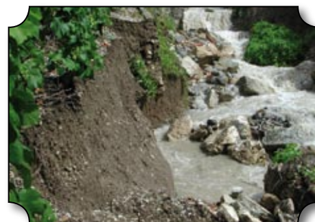
Erosion en rive droite
